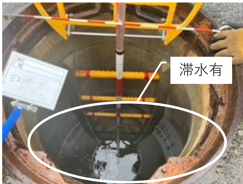
マンホール内滞水状況
