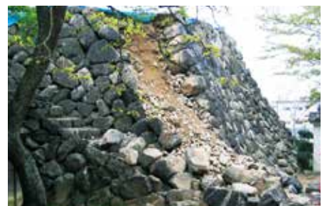
Parede de pedra desabada
