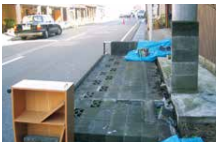
Muro de blocos tombado
