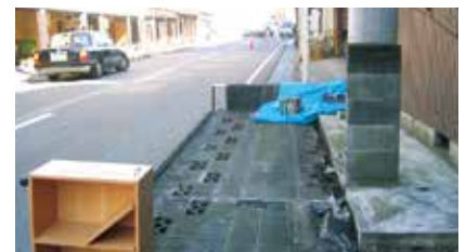
Muro de bloco tombado
