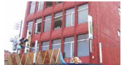
Queda dos vidros quebrados da janela
