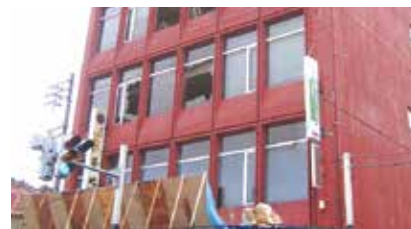
破损、掉落的窗户玻璃
