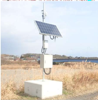
簡易型河川監視カメラ
