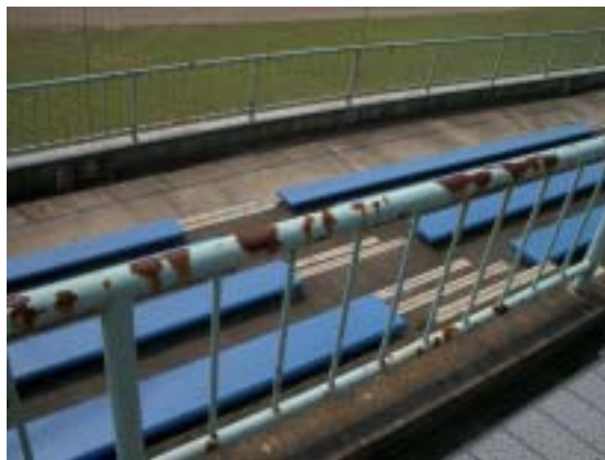
写真 錆が目立つ観客席の手すり
