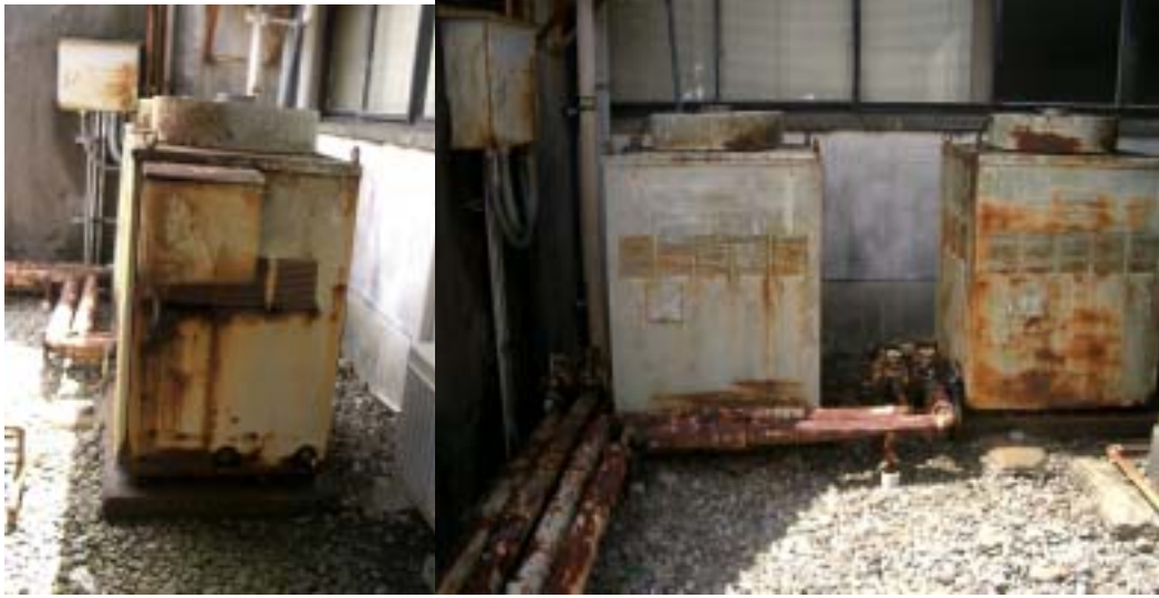
写真 別館の空調機。ところどころの金属が腐食している。
