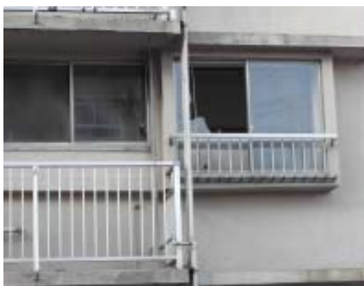
(窓ガラスが破損している閉鎖棟)
