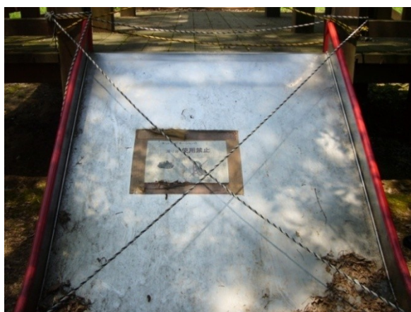
写真5-19-4 破損した滑り台
