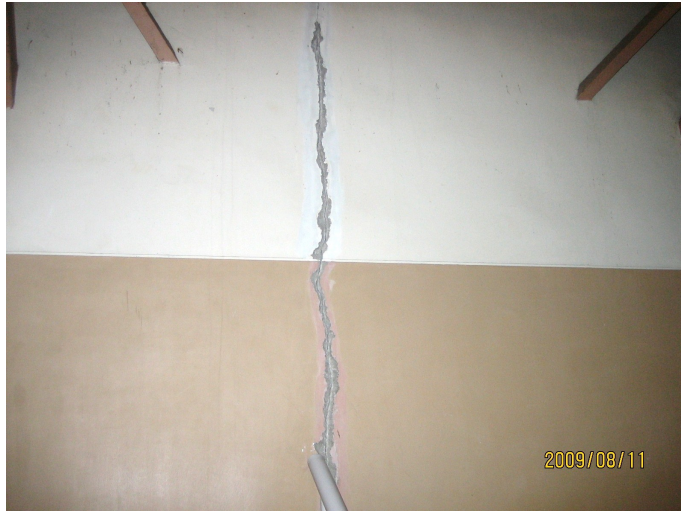
写真 5-26-4 ひび割れが発生している箇所
