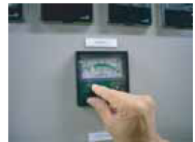
ばい煙濃度計の精度調整（本庁舎）
