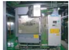
冷温水発生機（本庁舎）
