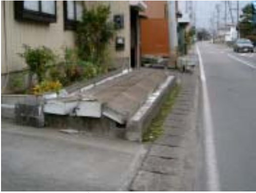
ブロック塀の被害状況
