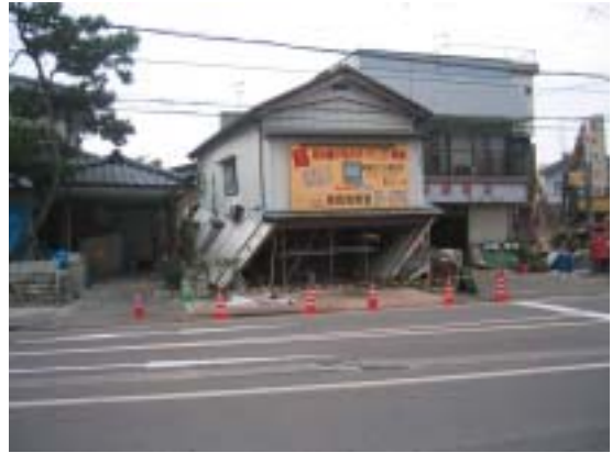
木造建築物の被害状況
