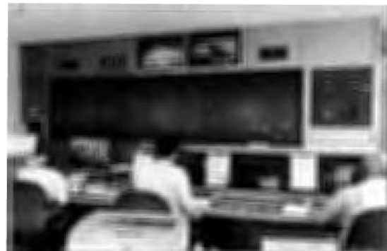
高野浄水場中央制御監視盤の状況
