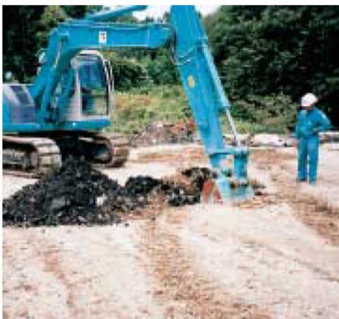
3 覆土で覆い隠された不法投棄現場
