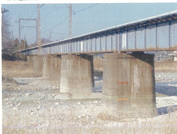
【三岐鉄道 宇賀川橋梁 橋脚修繕前】
