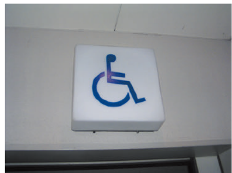
多機能便房の表示です。夜間に照明を灯す仕組みとなっています。
