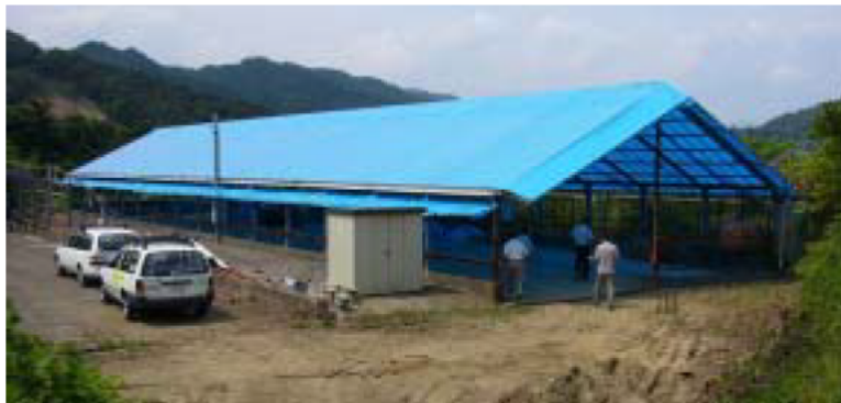
生ごみ堆肥化実験場(全景)
