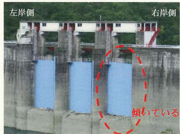
(右岸側のゲートが傾いた状況)
