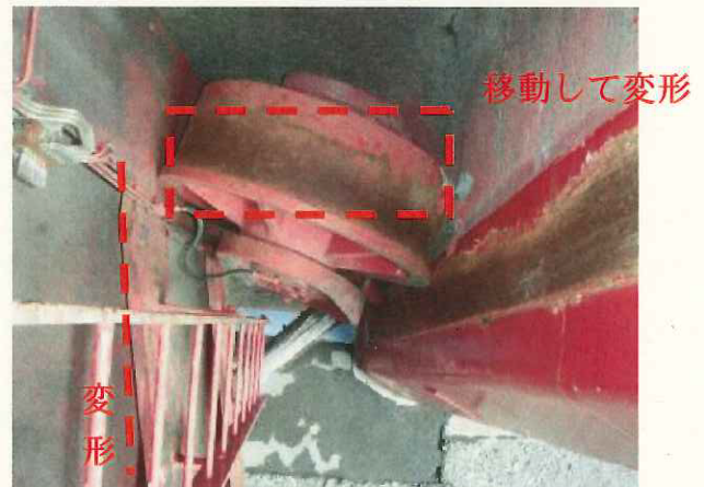
(ゲートの下流側にある主ローラー取付部が変形破損している状況)
