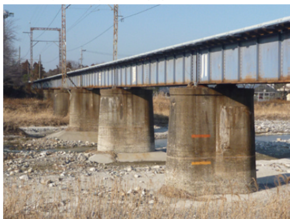
【三岐鉄道 宇賀川橋梁 橋脚修繕前】
