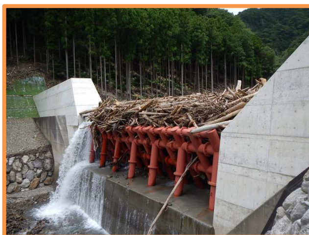
事例 1 治山施設に異常堆積した流木
