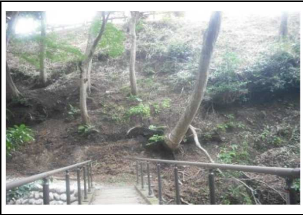
写真 対策2 暮らしに身近な森林づくり (四日市市) 水沢もみじ谷景観整備事業 【進捗:完了】 実施前(法面崩落状況)
