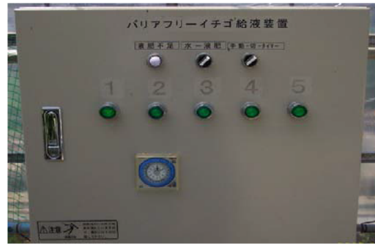
写真2 バリアフリー給液装置
