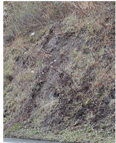
道路法面にできたシカの通り道。土砂が流出している。
