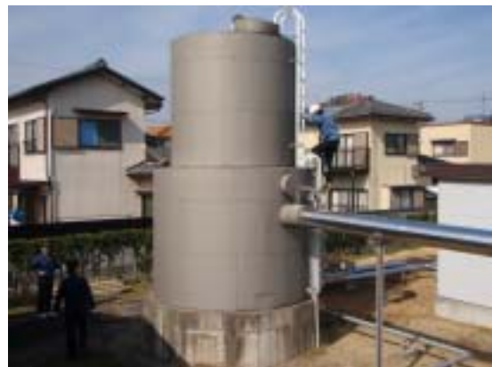
写真1 ガス分離設備でのメタン測定
