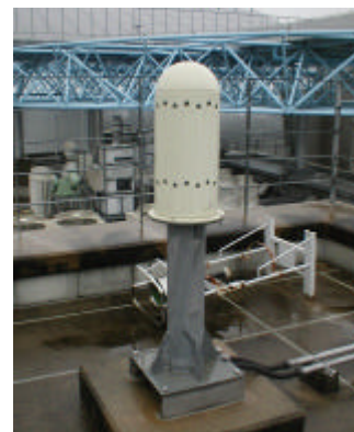
写真 - 2 モニタリングポスト検出部
