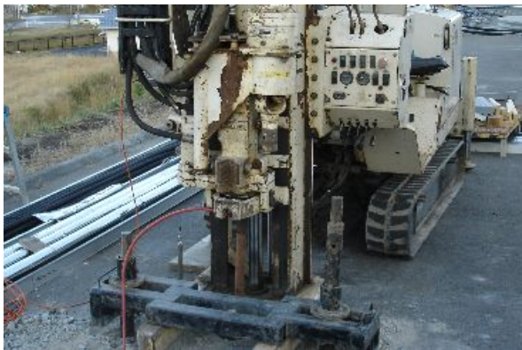
写真1 コーン貫入試験機によるVOC汚染調査。センサーの付いたコーンを貫入し、リアルタイムでVOC成分毎の濃度が測定できます。
