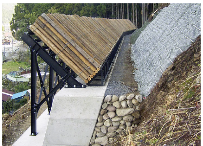
落石防止工の緩衝材 (熊野市)
