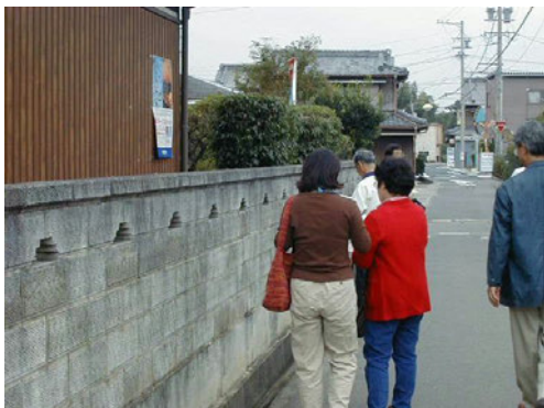
ブロック塀は崩れてこないか
