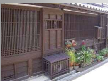
エアコンの室外機を修景している。（奈良県奈良市）
