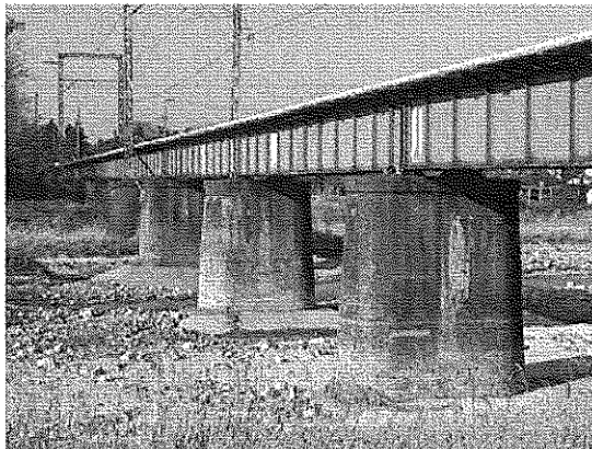
【三岐鉄道 宇賀川橋梁 橋脚修繕前】
