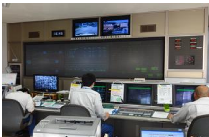
高野浄水場中央制御監視盤の状況
