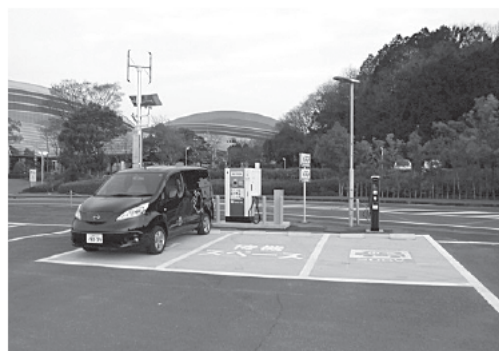
県営サンアリーナに設置したEV充電施設 (急速1基、普通1基)
