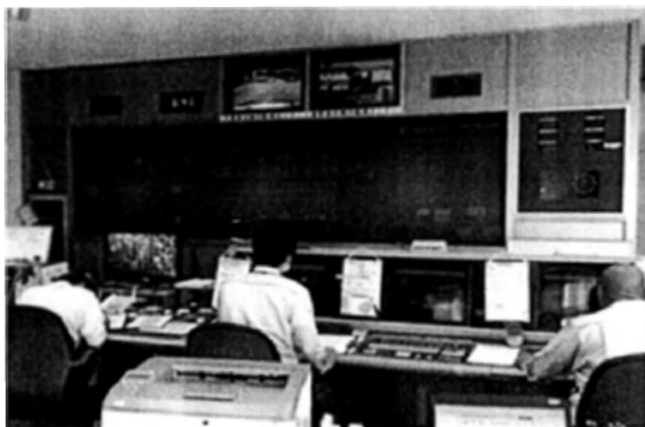
高野浄水場中央監視制御盤の状況
