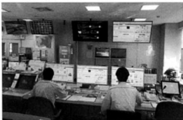
高野浄水場中央監視の状況
