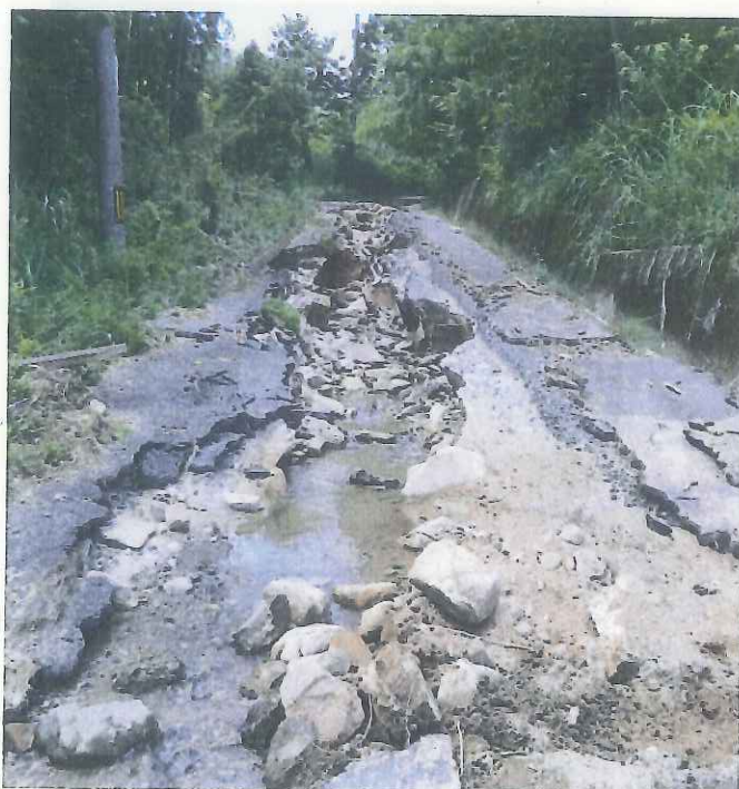
今回の豪雨で被災した進入路
