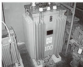
変圧器（トランス）
