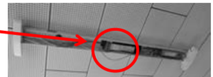
蛍光灯の安定器
