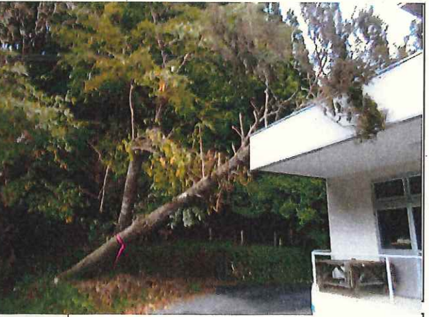
写真5 崎地内その1大紀中学校危険木
