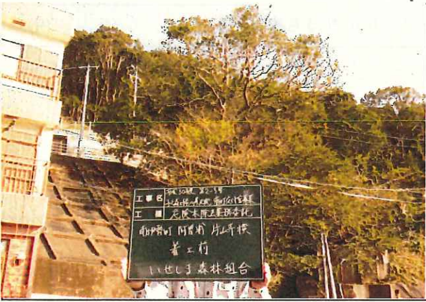
写真1 危険木除去(阿曾浦)避難道 実施前 避難道に巨木が覆い被さり倒木の可能性がある。
