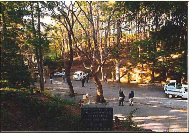
写真3 危険木除去(神津佐) 実施前 区の行事を行うことが多い場所でも木が覆い被さってきて危険である。
