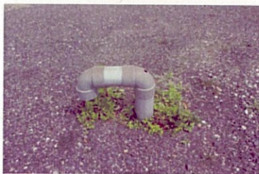
(ガス拡散施設)
