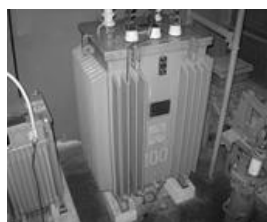
変圧器 (トランス)
