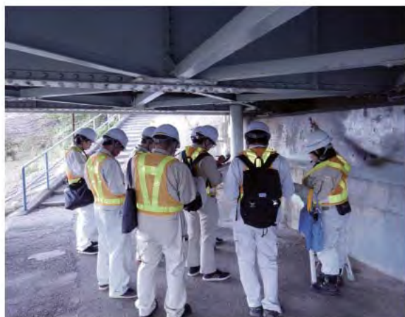
損傷の確認状況(横桁)
