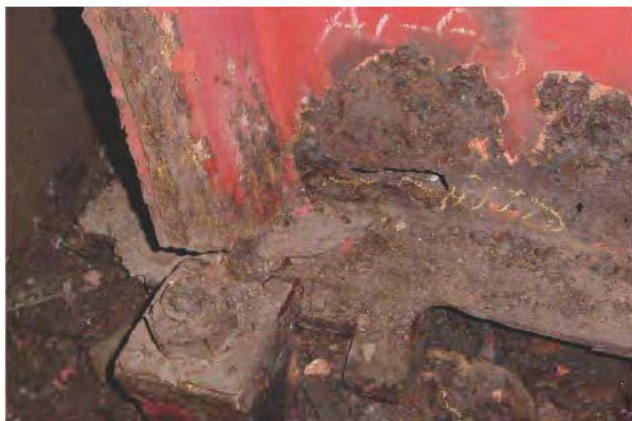
漏水による腐食(桁端部)
