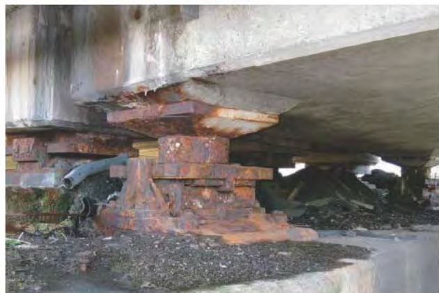
漏水による腐食(支承)
