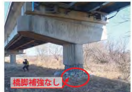
耐震補強未実施 橋脚が地震動により損傷あり(東日本大震災)
