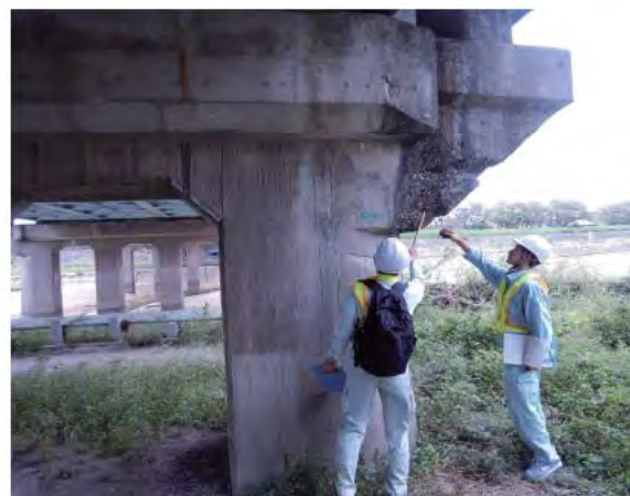
損傷の確認状況(橋脚)
