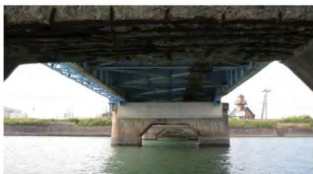
(橋脚部のコンクリート剥離および鉄筋露出)
