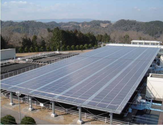
太陽光発電設備
