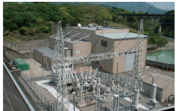
三瀬谷発電所
