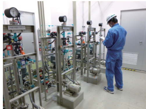
薬品注入設備の点検
