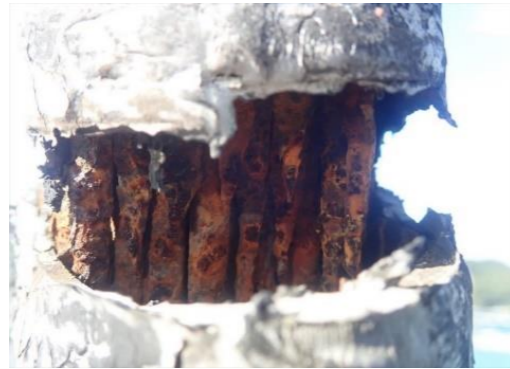
損傷箇所②
