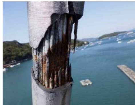
損傷箇所③
