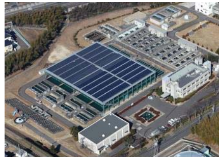
太陽光発電設備（播磨浄水場）
