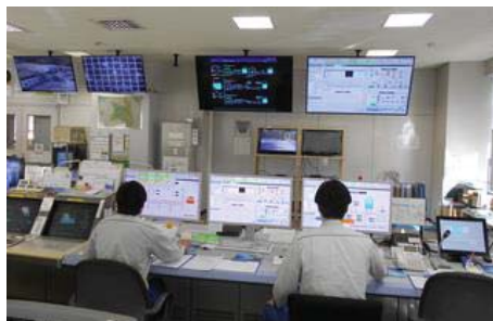
高野浄水場中央監視の状況
