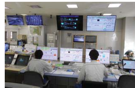
高野浄水場中央監視の状況
