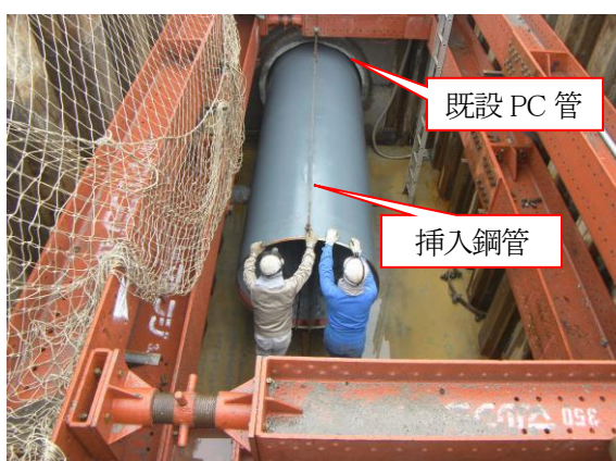
PIP工法による既設管への鋼管挿入状況 (内径1000 耗PC管布設替)
