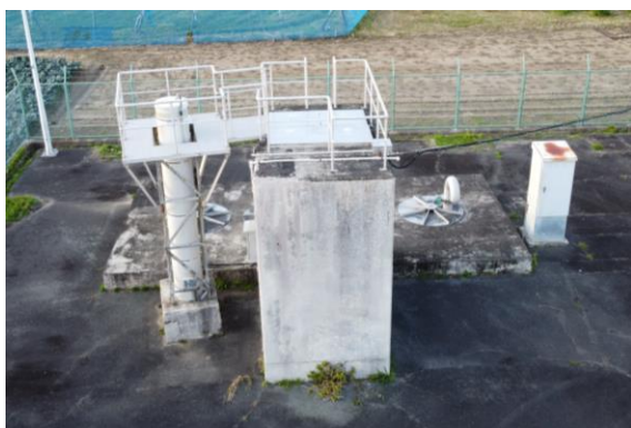
耐震補強工事予定の木造取水所取水ポンプ井 (令和4～5年度施工予定)
