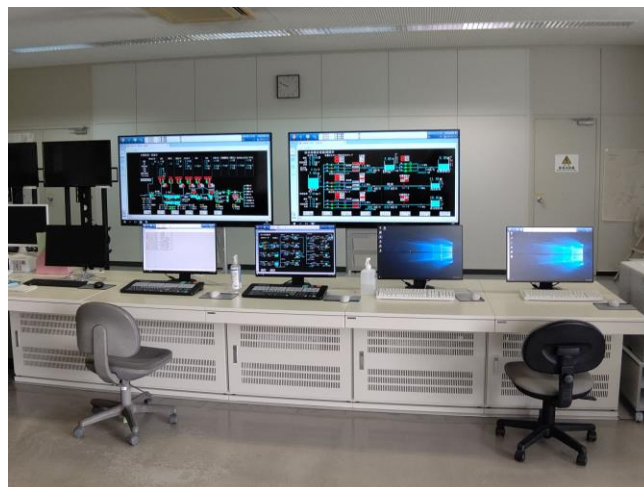
更新が完了した大里浄水場の中央監視制御設備 (令和3年度完了)
