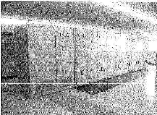
安永取水所（桑名市）直流電源装置
