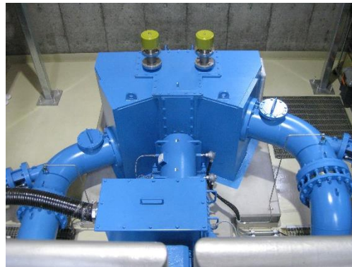
写真：馬野川小水力発電所（伊賀市）
