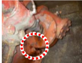
低水放流設備の漏油状況
