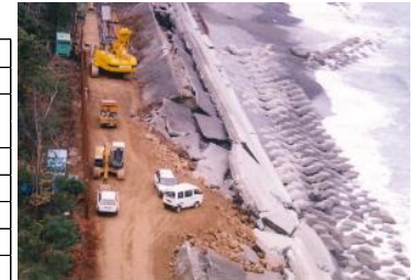
井田地区海岸平成9(1997)年被災状況
