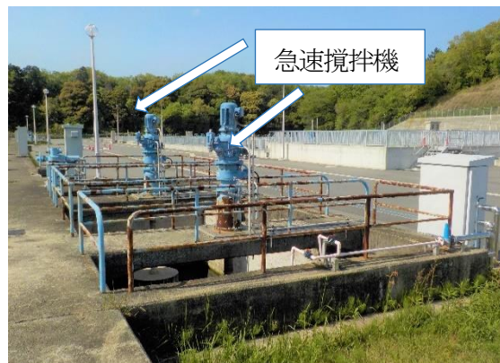
山村浄水場(四日市市) 急速攪拌機
