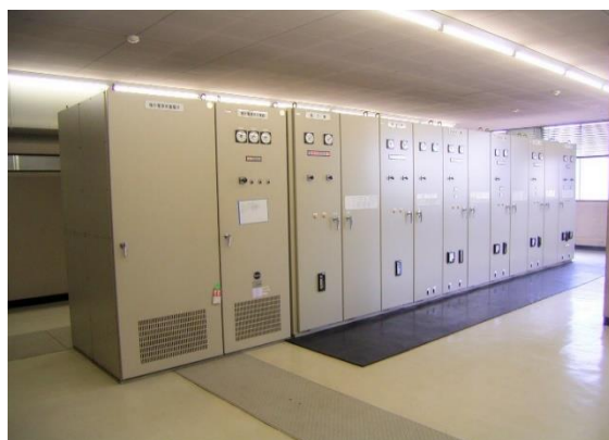
安永取水所(桑名市) 直流電源装置
