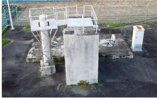
木造取水所（津市）取水ポンプ井
