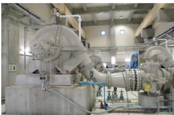
野代導水ポンプ所（桑名市）ポンプ設備
