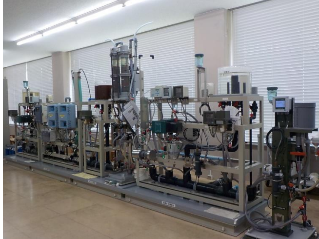
播磨浄水場（桑名市）自動水質測定装置
