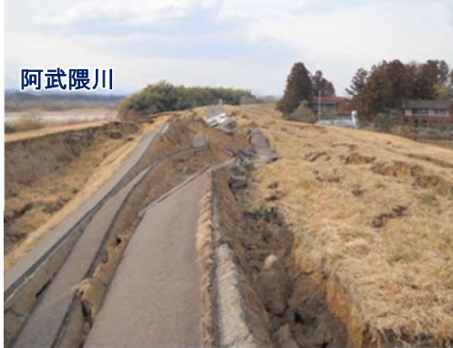
東日本大震災（宮城県阿武隈川） 写真提供：国土交通省東北地方整備局
