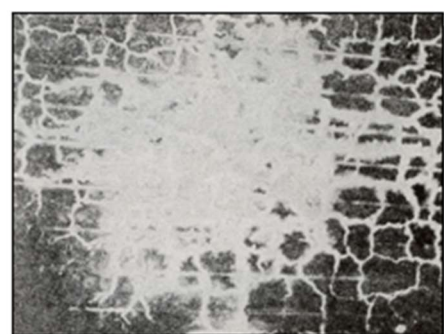
③貫通ひびわれへの進展
