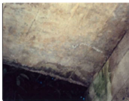
①1方向性のひびわれの発生
