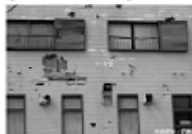
飛来物で壊れた壁
